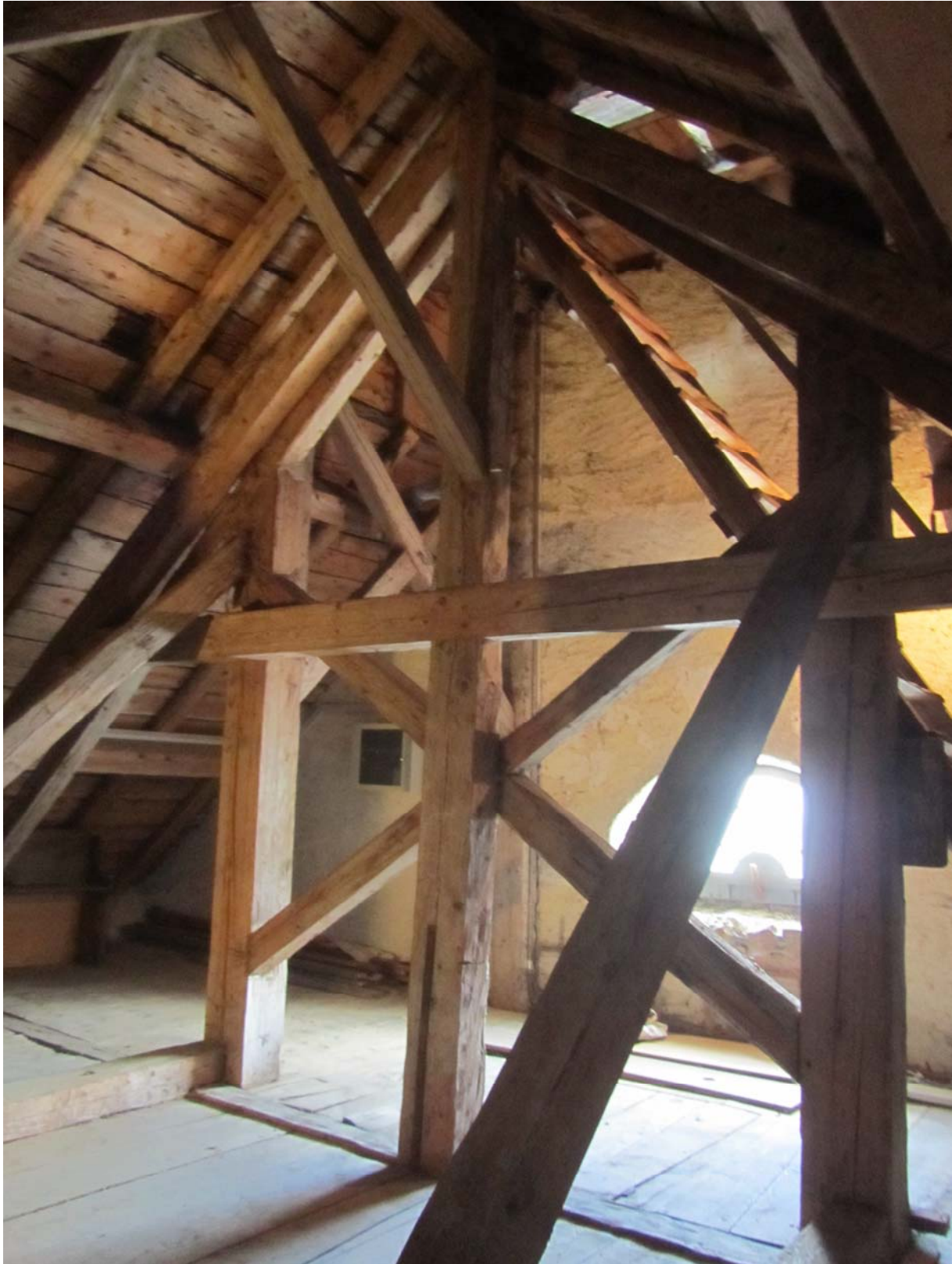
A gauche et à droite, les deux poutres qui, du sol, vont jusqu'à la hauteur du toit du clocher. De sacrées pièces d'environ 15 mètres de long.
